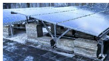
圖三，用石屎磚塊把光伏板和支架壓於天台。
