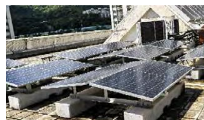
圖四，光伏板和支架固定在預制石屎躉上。
